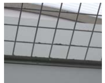
Elegantes Edelstahlnetz anstelle plumpem Baustahlgitter sichert die Lichtkuppeln.
