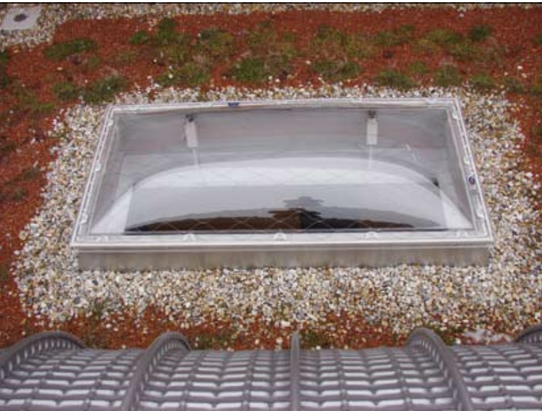
Eine durchsturz sichere Sadler-Likunet-Kuppel sorgt für Licht im neuen modernen Werkstättenzentrum der Berufsschule Mistelbach/NÖ..
